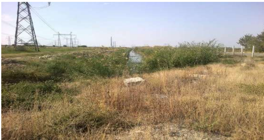
Фото. 2. Состояние КДС в Зафарабадском районе
